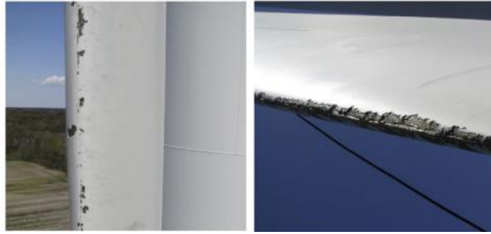
Figura 14. Erosión en palas de aerogeneradores.
