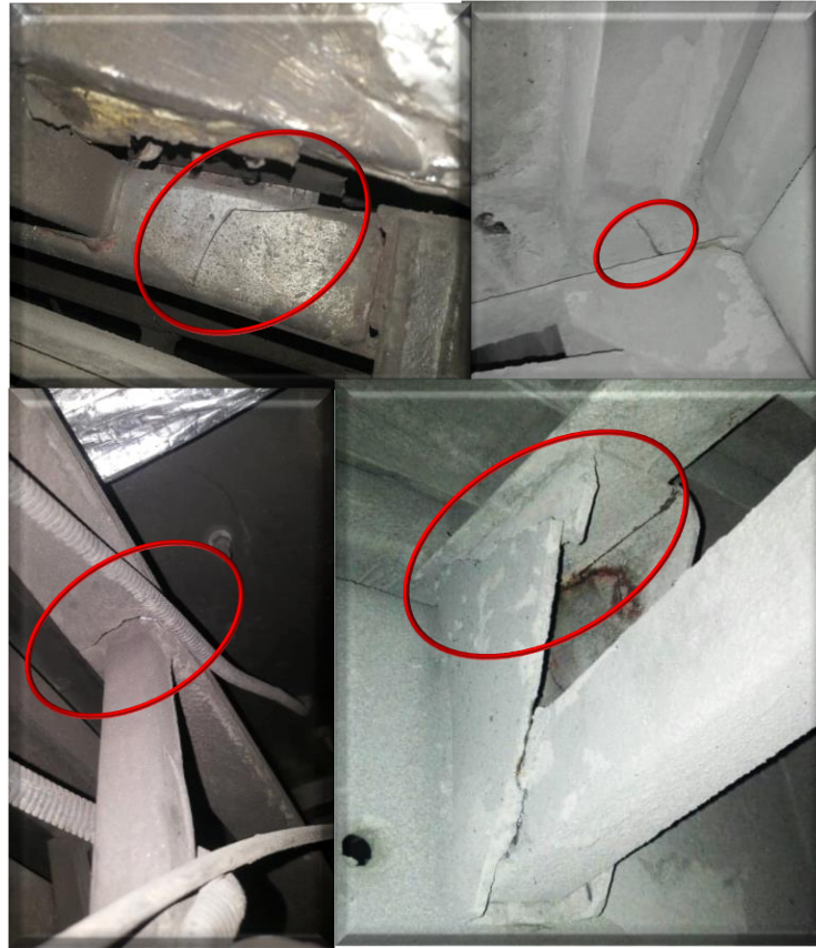
Figura 1 Fracturas presentes en la estructura de algunas unidades.
