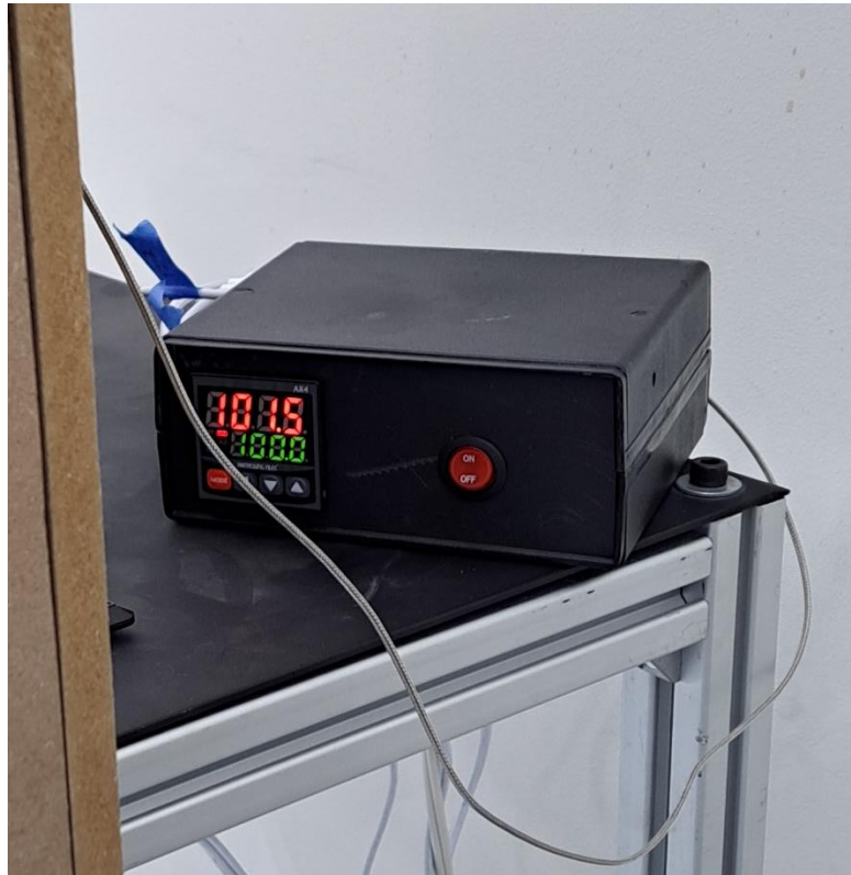
Figura 88. Controlador a temperatura de 100°C.
