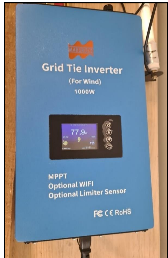
Figura 18: Inversor utilizado a la salida del aerogenerador, modelo SUN-1000G-WAL-M-U.
