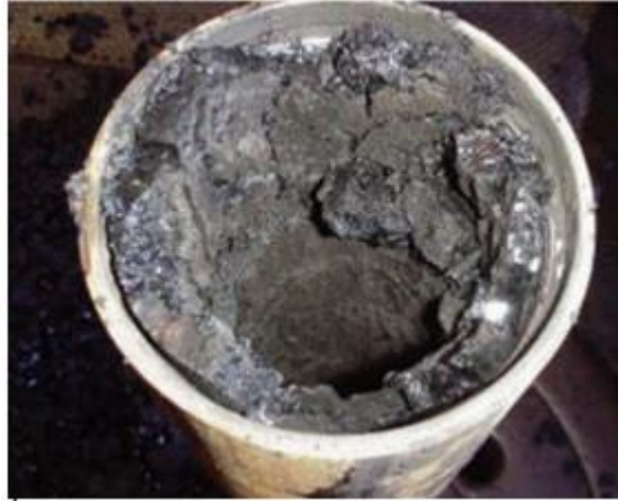
Figura 6. Problema típico de sedimentos en una tubería de producción de hidrocarburos.
