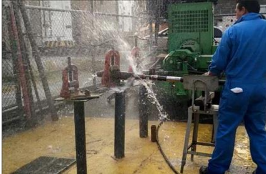
Figura 77. Prueba del funcionamiento del sistema hidromecánico
