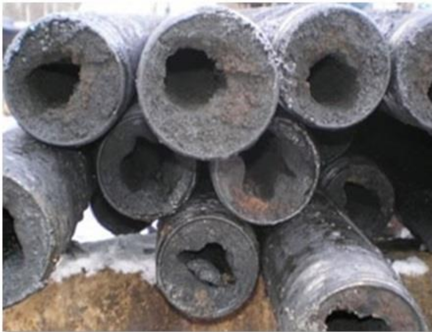
Figura 8. Obstrucción parcial de tuberías de producción
